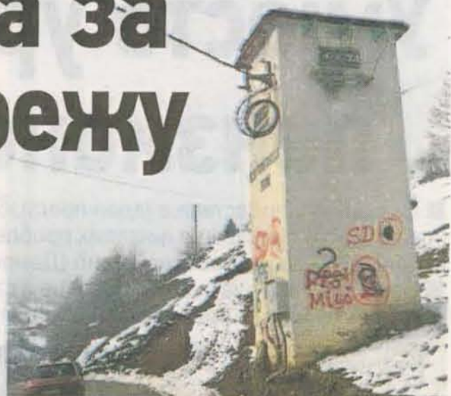
Дотрајала трансформаторна станица у Петњици
